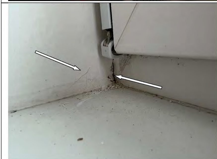
Фото №18. Трещина по откоосу и отслоение штукатурного слоя окрашенного откоса оконного блока ПВХ в кухне-гостиной.
