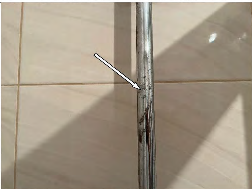
Фото №35. Царапины на смесителе душевой кабины в ванной комнате.
