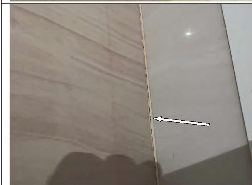
Фото №12. Трещина затирочного раствора в шовном пространстве настенной керамической плитки в ванной комнате.
