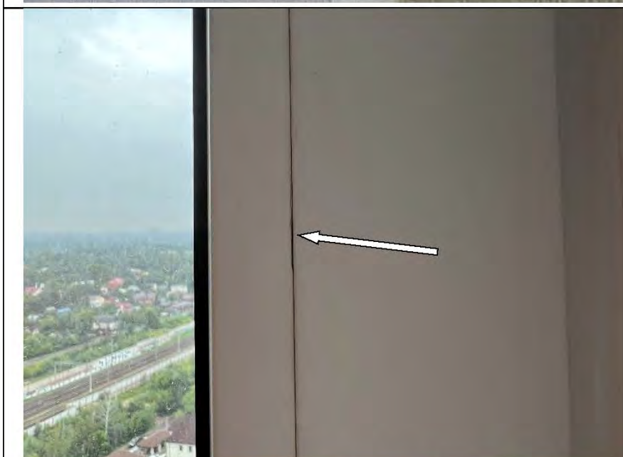
Фото №20. Механическое повреждение (скол) лицевой поверхности профиля ПВХ оконного блока в кухне-гостиной.
