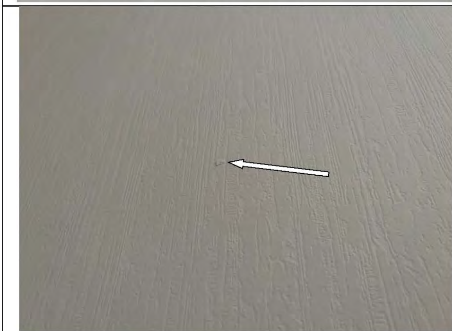
Фото №9. Механическое повреждение обойного полотна в коридоре.
