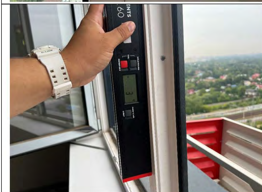
Фото №21. Отклонение рамы оконного блока ПВХ в кухне-гостиной по уровню вертикальности составляет 3 мм.
