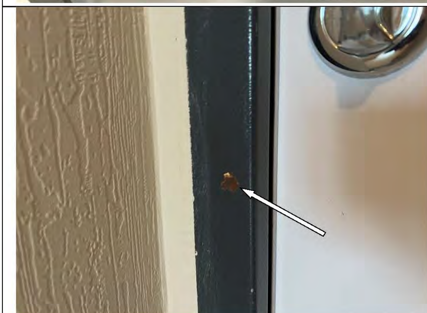
Фото №27. Скол и образование коррозии на коробке входного дверного блока.
