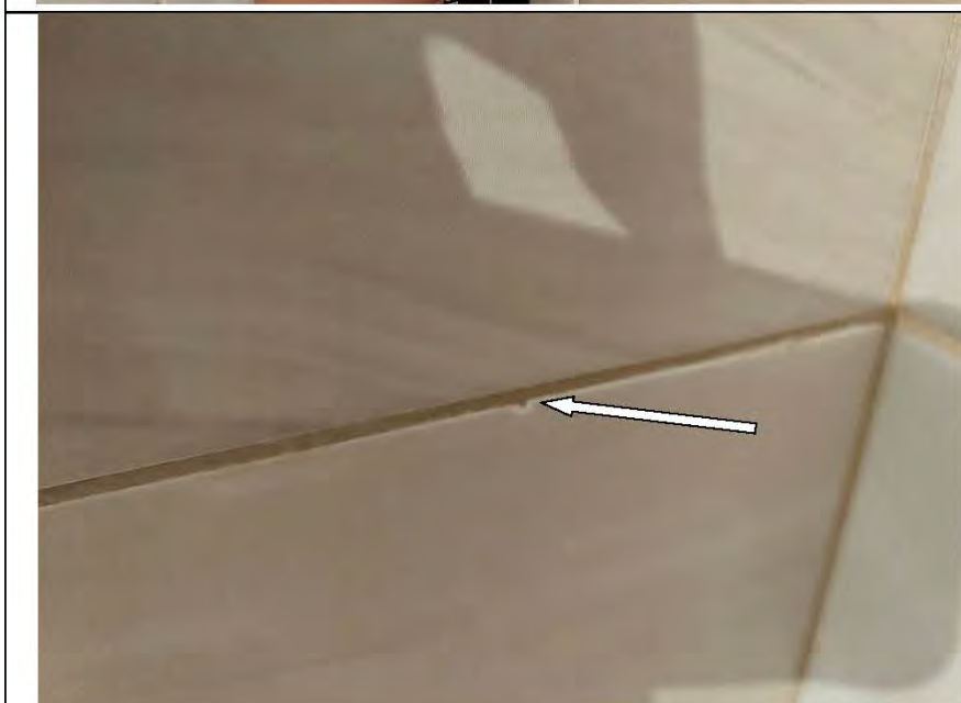
Фото №11. Отбитости настенной керамической плитки в ванной комнате.
