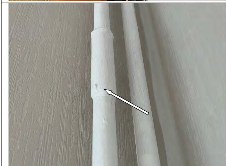
Фото №32. Подтеки краски на трубах отопления в кухне- гостиной.
