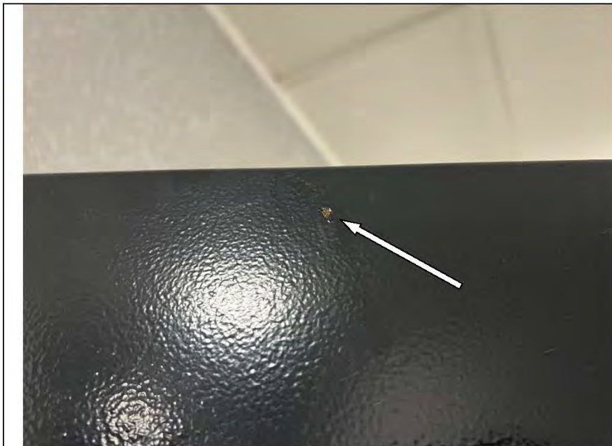
Фото №25. Скол и образование коррозии на лицевой поверхности полотна входного дверного блока.
